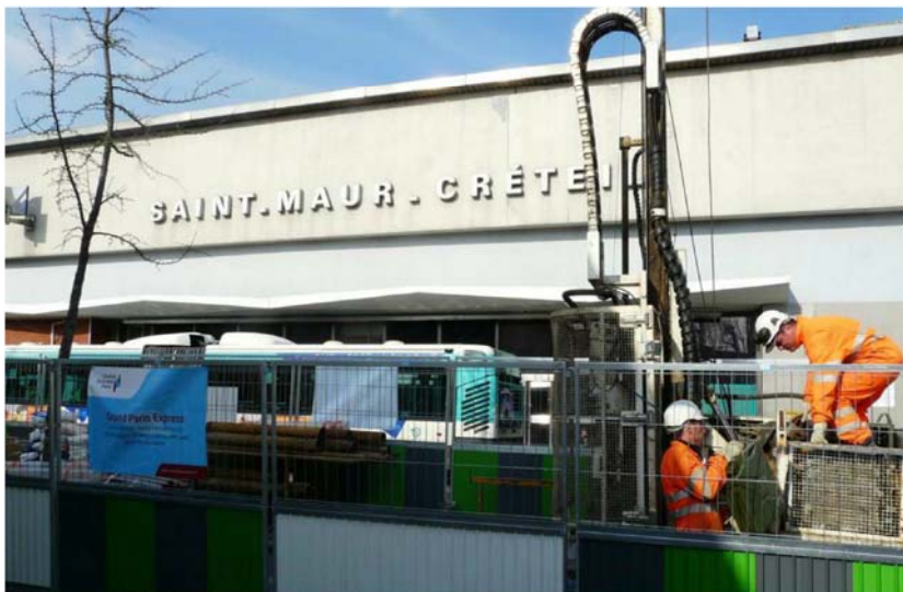
SAINT-MAUR-DES-FOSSÉS (VAL-DE-MARNE), LE 20 MARS. Des forages préparatoires à la construction des futures gares du Grand Paris Express ont déjà débuté, comme ici devant la station du RER A Saint-Maur-Créteil. (L.P./L.M.)
