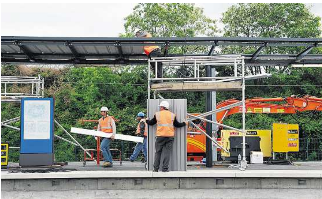
Installation d'abris à la station RER du Blanc-Mesnil, en Seine-Saint-Denis. MICHEL LE MOINE/DIVERGENCE
