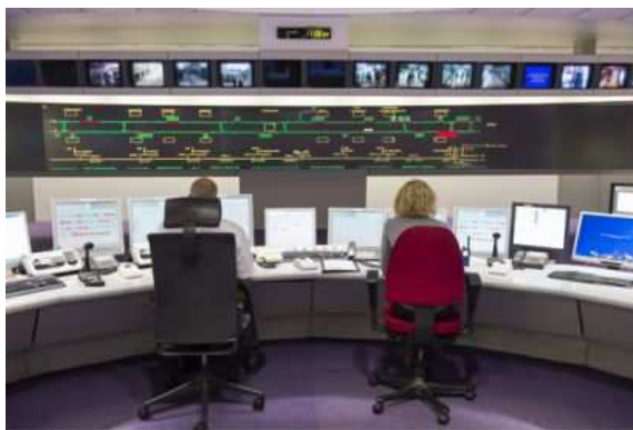
Le poste de commandes centralisées mobilise 300 personnes, 7 jours/7, 24h/24 à la station Bercy. © DR
