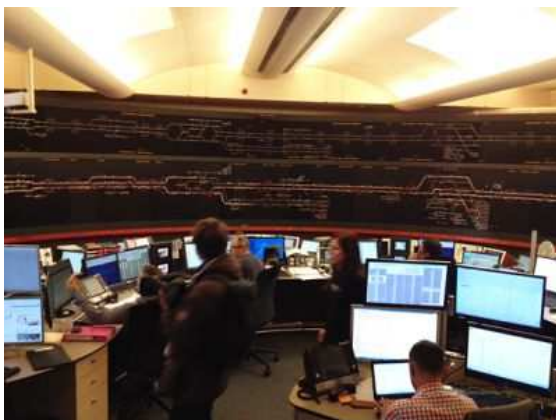
Le centre de commandement unique est situé à Denfert-Rochereau. © FG
