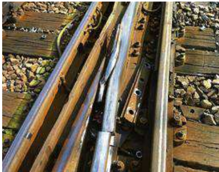
La fissure sur l'éclisse – la pièce de l'aiguillage qui a provoqué le déraillement – a été détectée dès 2008, soit cinq ans avant l'accident.
