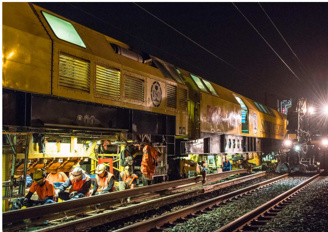
Chelles-Gagny, vendredi, 2 heures du matin. Ce train-usine permet de changer des rails quatre à cinq fois plus vite qu'avec les procédés habituels. Il a été utilisé pour la première fois cet été en Ile-de-France. (LP/Jean-Marc François.)
