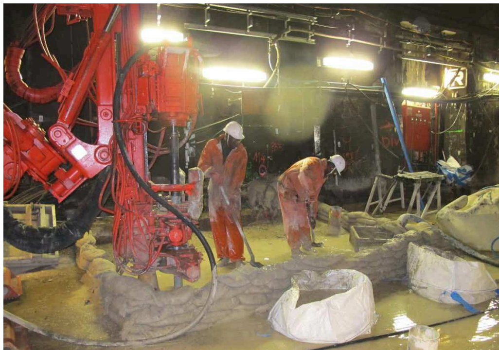
Gare Saint-Michel-Notre-Dame (V e ). Les travaux de renforcement de l'assise des tunnels du RER C entre Paris-Austerlitz et Invalides dureront jusqu'au 27 août inclus.
