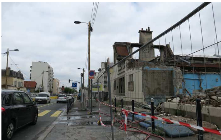
Champigny-sur-Marne (Val-de-Marne), hier. Murs antibruit, double vitrage... Les riverains pourront bénéficier d'aménagements techniques voire d'aides financières de la part de la Société du Grand Paris. (LP/LP.)
