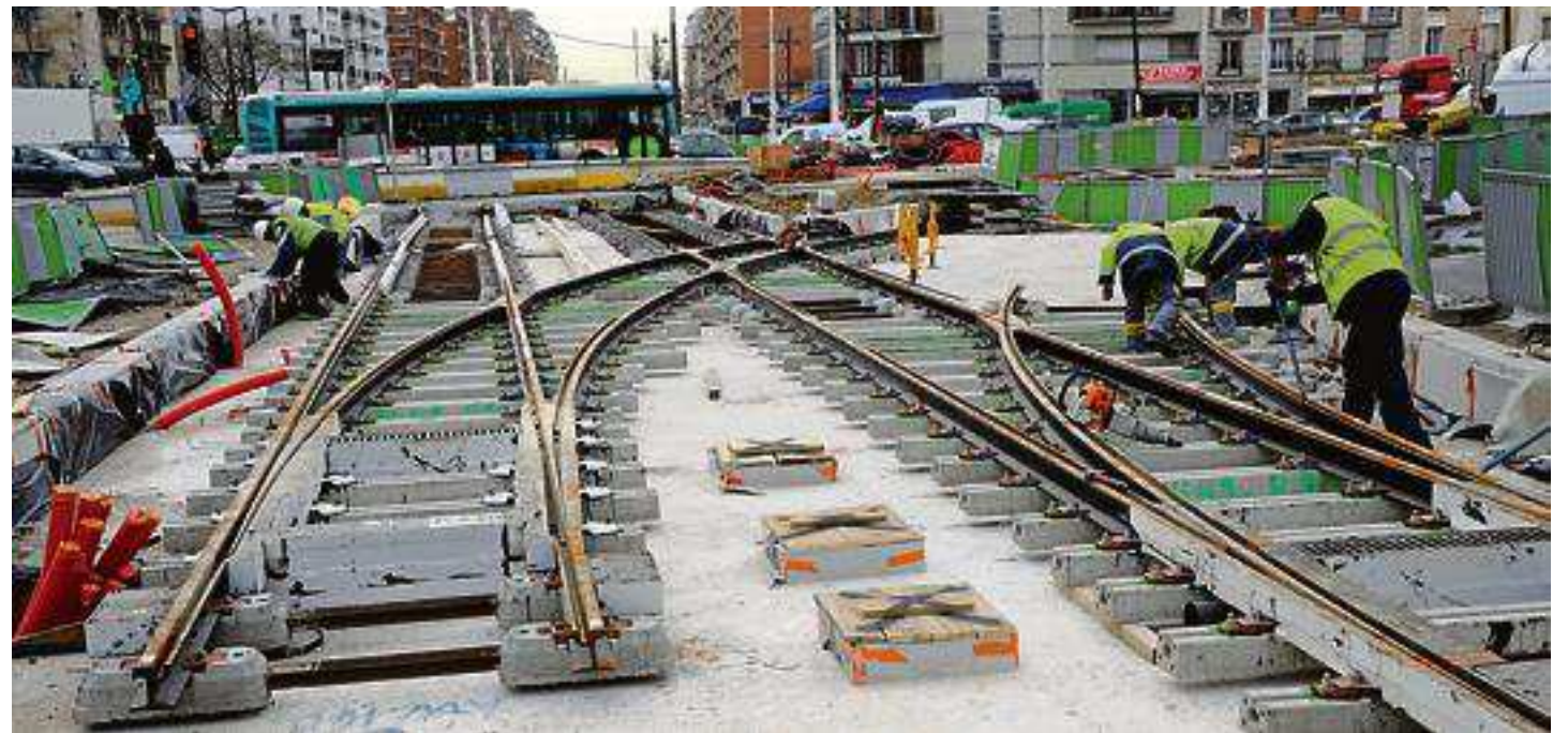
Le prolongement du Tramway T3, lancé par la Ville de Paris il y a deux ans, a pris plusieurs mois de retard. En cause : la découverte d'actinolite dans les revêtements de la chaussée. Photo Gilles Rolle/RÉA
