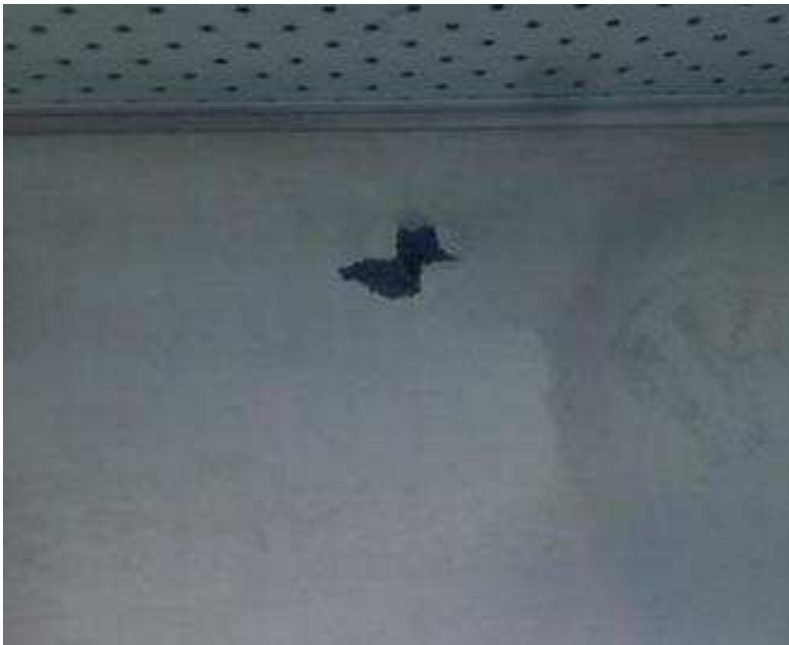
La balle s'est fichée dans une paroi intérieure
