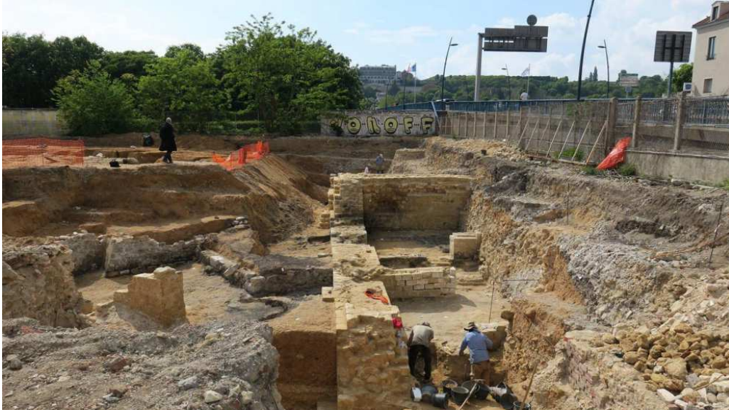
Le Pecq. Une opération immobilière est prévue à l'emplacement de l'ancienne gare. Les fouilles, qui ont duré près de trois mois se sont révélées extrêmement fructueuses pour les experts du rail. LP/Sébastien Birden
