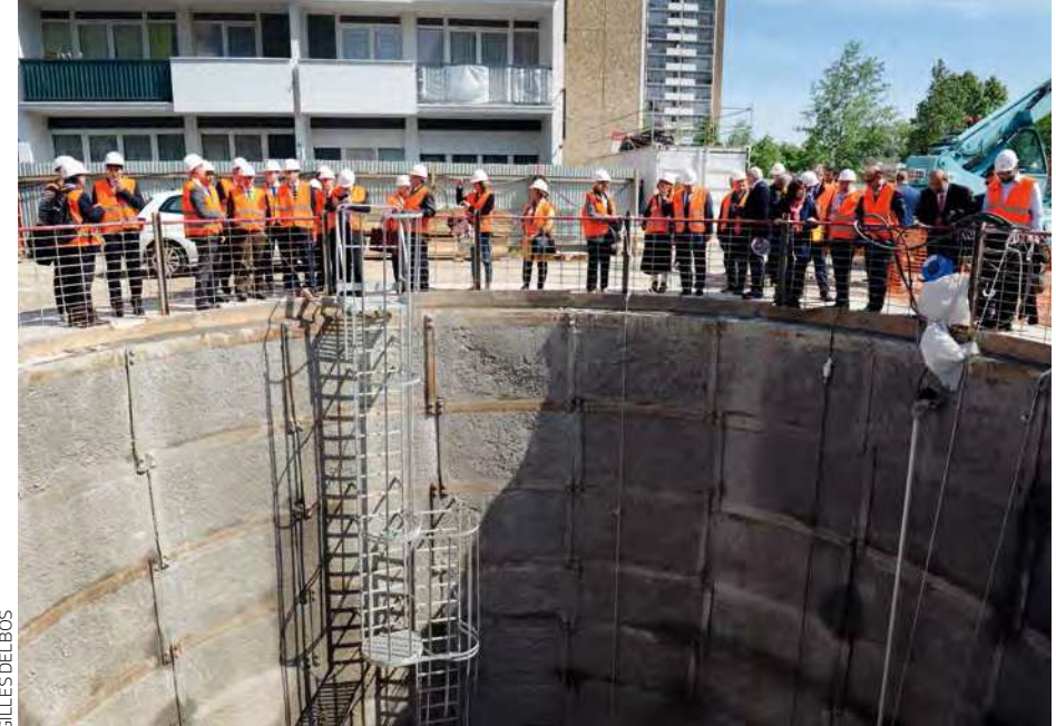
La ligne de métro 11 va bientôt atteindre Montreuil. Aux Lilas, le premier puits d'accès au futur souterrain est déjà creusé.
