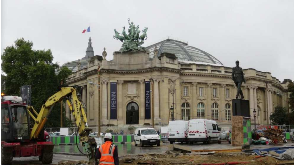
Gros travaux au Grand palais. Une nouvelle sortie du métro est en train d'être creusée. En même temps, l'étanchéité de la station est en cours. LP/Eric Le Mitouard
