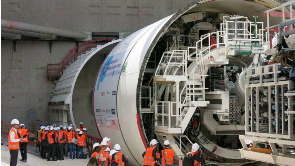
Illustration. Le géant Eiffage vient de remporter le marché pour la construction du tronçon Créteil-Echat-Bry-Villiers-Champigny de la ligne 15 sud du Grand Paris Express. LP/Julien Duffe
