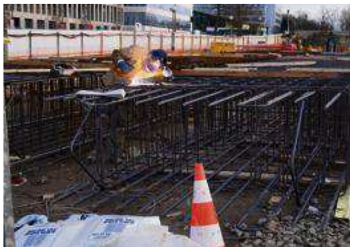
Les PME peuvent bénéficier de fonds européens pour participer aux chantiers. Ici, construction de la future gare de métro de Noisy-Champs, entre Noisy-le-Grand et Champs-sur-Marne.
