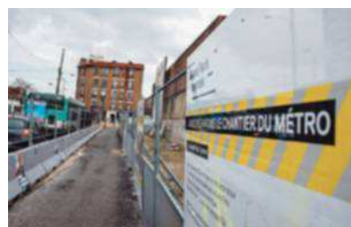
Chantier du métro du Grand Paris Express à Villejuif, dans le Val-de-Marne. LEVESQUE/IP3 PRESS/MAXPPP
